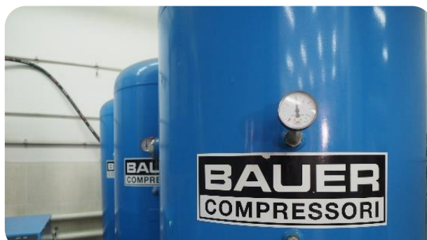
2 станции по произв. N2
