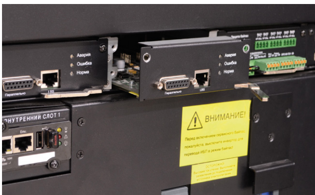
Рисунок 2. Модули управления ИБП с резервированием и «горячей» заменой
